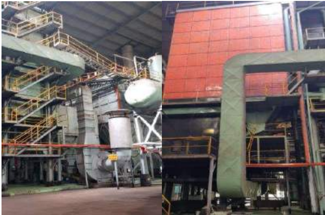
Lò hơi nước bão hòa
